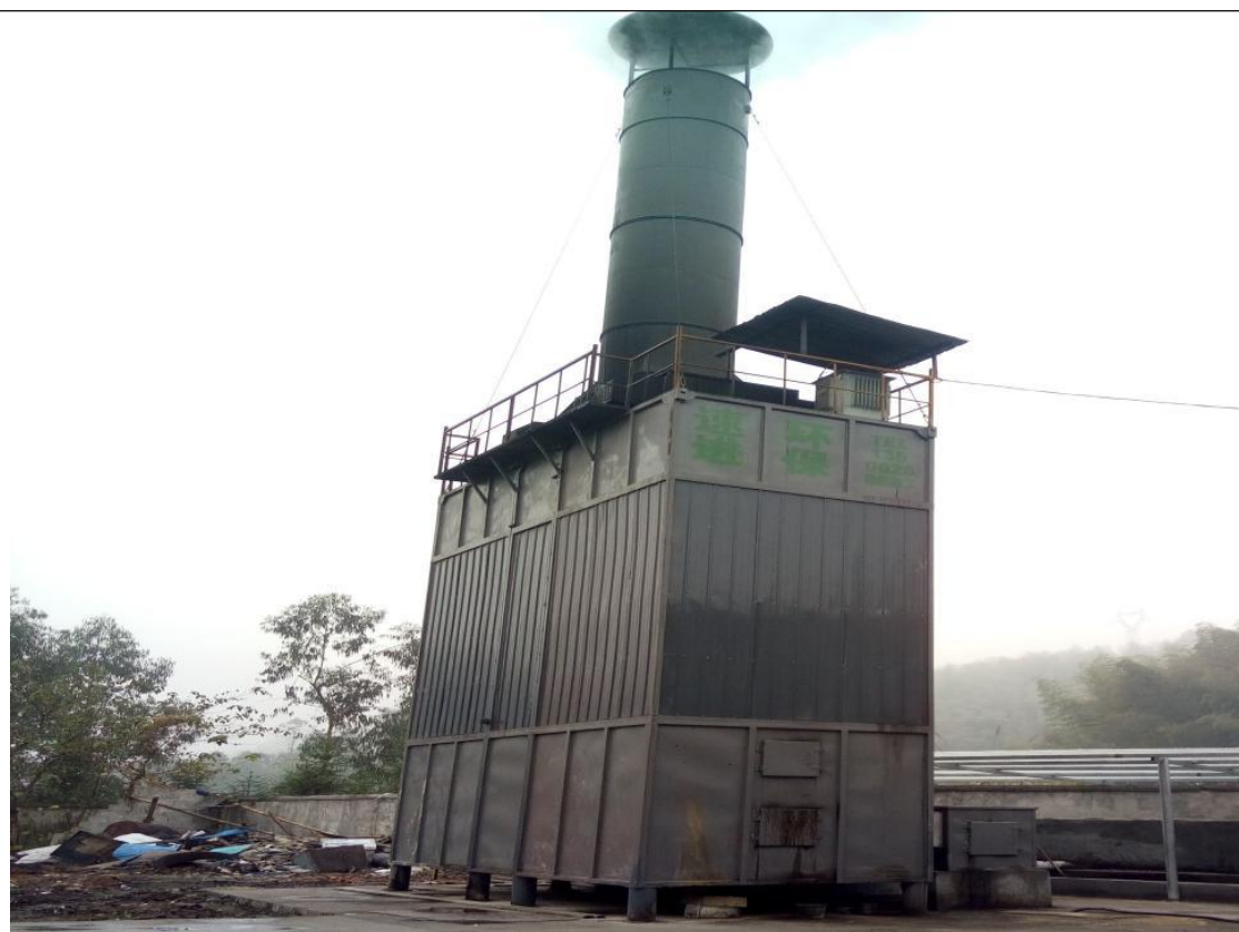
废气处理设施
